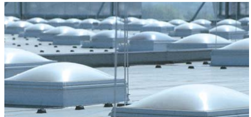
Mit gleichmäßig verteilten Dachoberlichtern lassen sich Innenräume flächig ausleuchten.
