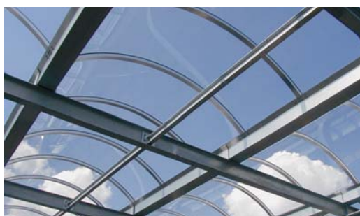
Die Lichtflächen von Lichtkuppeln und Lichtbändern werden meist aus thermoplastischen Kunststoffen hergestellt, deren Schmelztemperatur unter 300 °C liegt.
